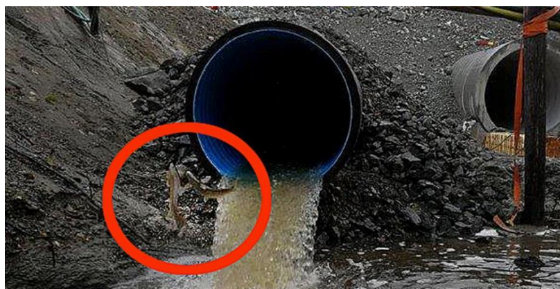
Figur 13. her prøver 2 sjøørreter å komme seg opp i en kulvert under vei i Ratbekken i Melhus kommune i 2017. © Lars Petter Wassmo.
