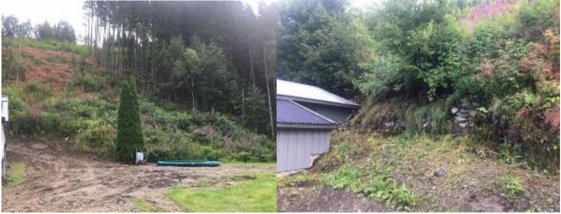
Figur 20. Observert potensiell jordskredfare bak hus nr. 18, på grunn av en bratt jordskjæring som ikke er vegetert og tegn på bevegelse bak eksisterende støttemur.
