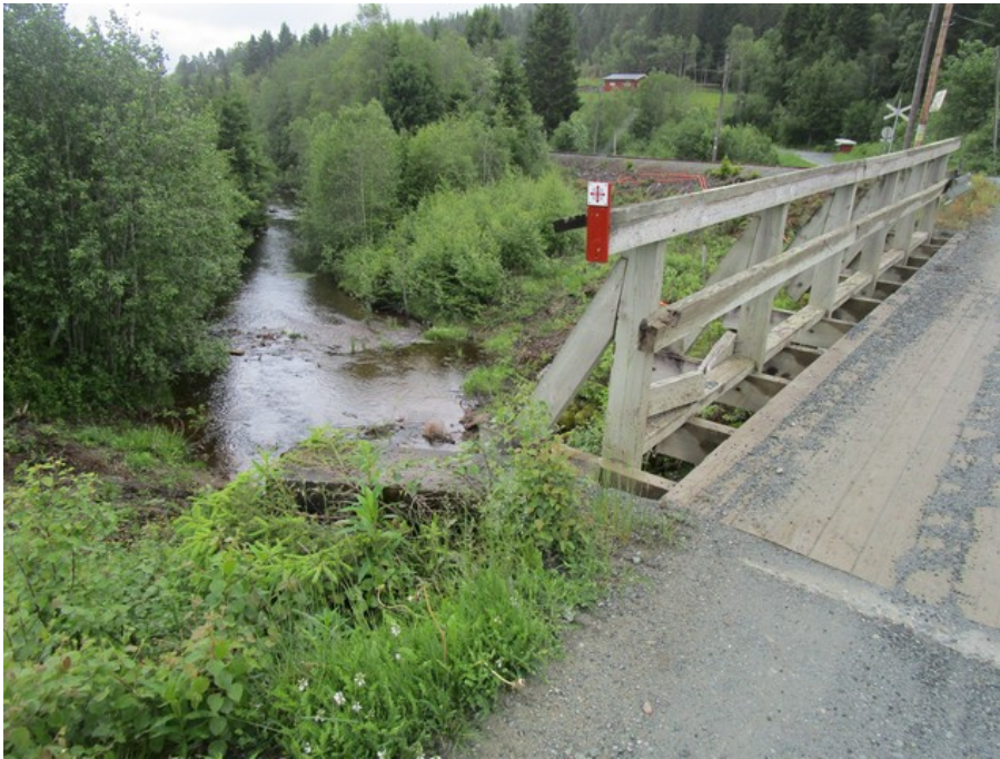
11- Manglende rekkverk, akse 2-3
