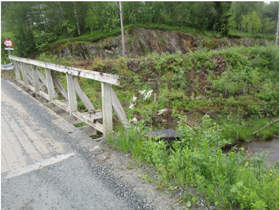
12- Manglende rekkverk, akse 2-3
